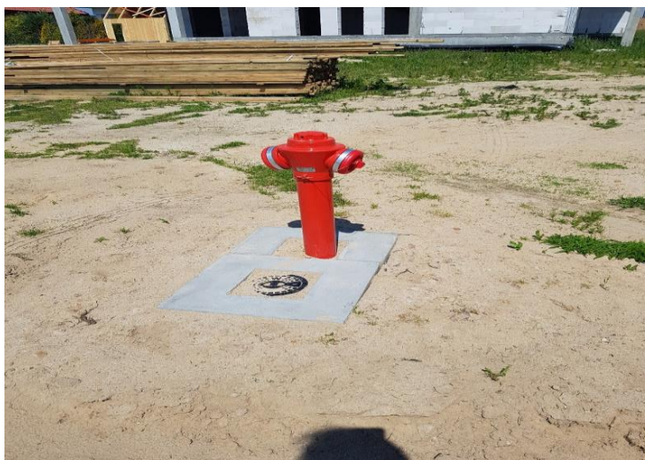
Hydrant i zasuwka na nowo wybudowanym odcinku sieci wodociągowej w miejscowości Rogozino
