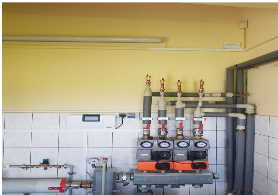
Kotłownia w budynku Zespołu Szkolno-Przedszkolnego w Rogozinie
