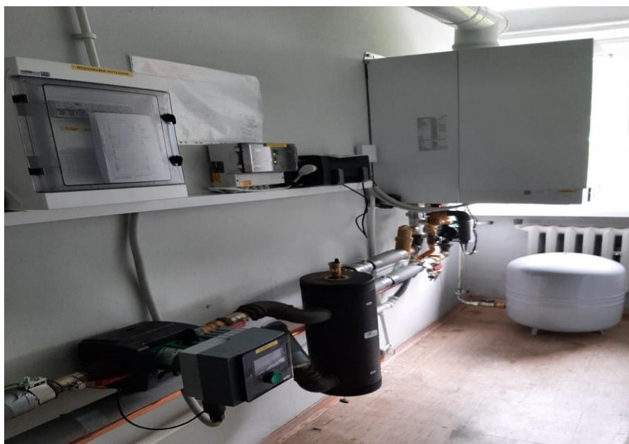
Kotłownia w budynku Urzędu Gminy w Radzanowie
