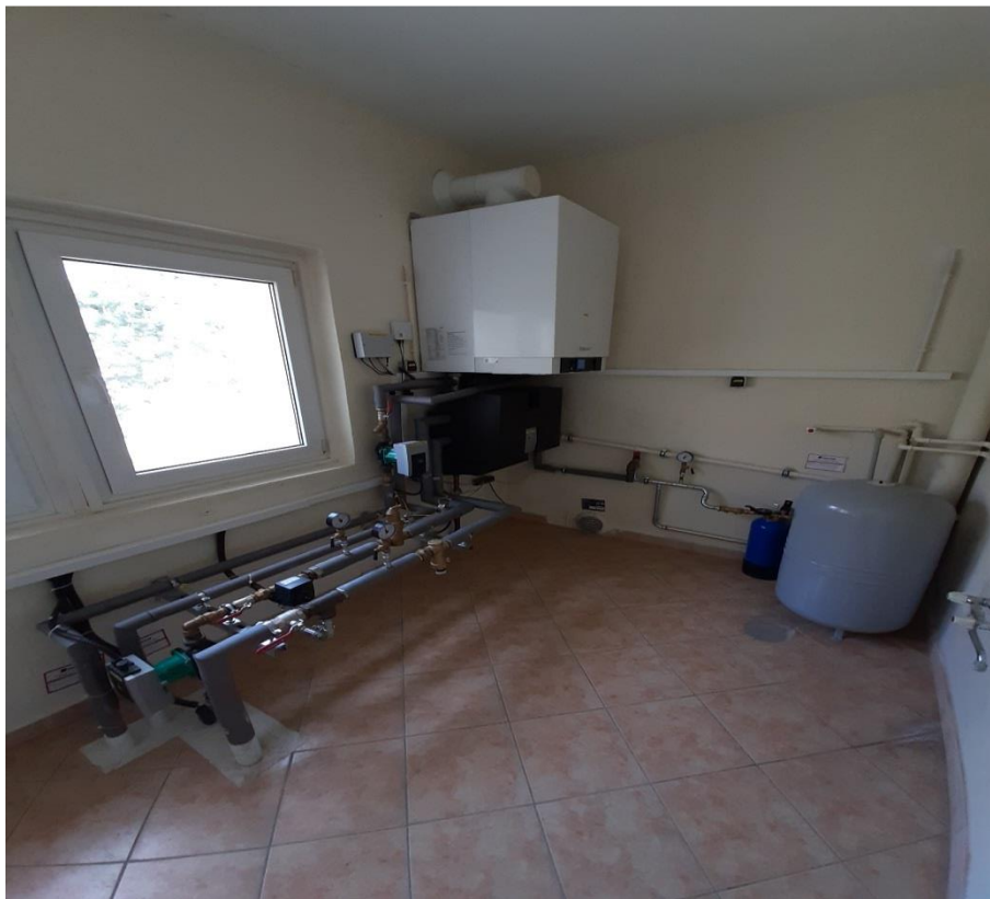
Kotłownia w budynku Samorządowego Przedszkola w Radzanowie
