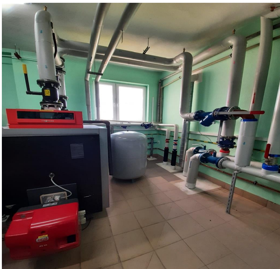
Kotłownia w budynku Szkoły Podstawowej w Radzanowie
