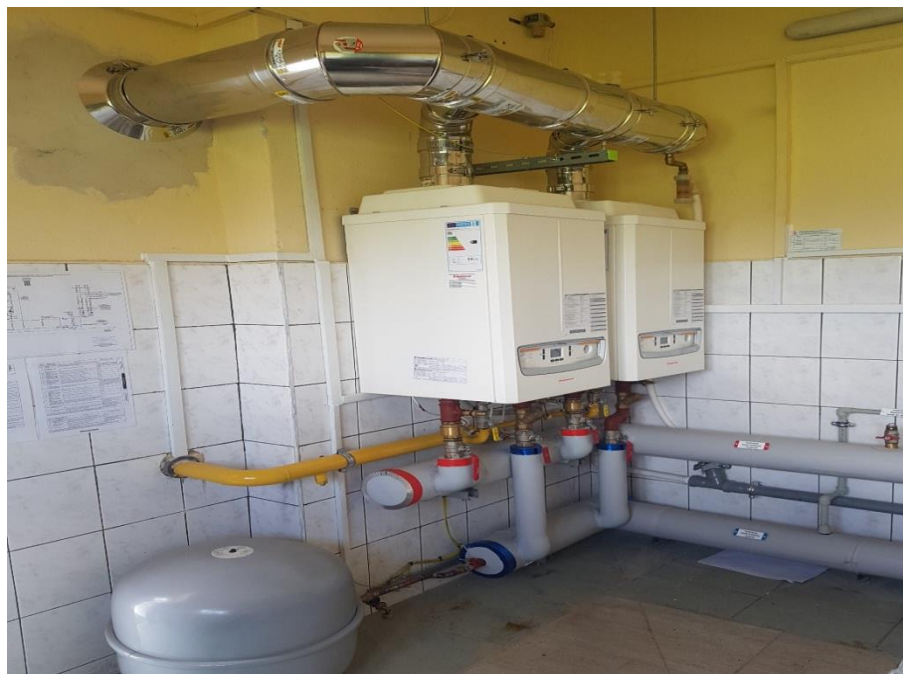
Kotłownia w budynku Zespołu Szkolno-Przedszkolnego w Rogozinie
