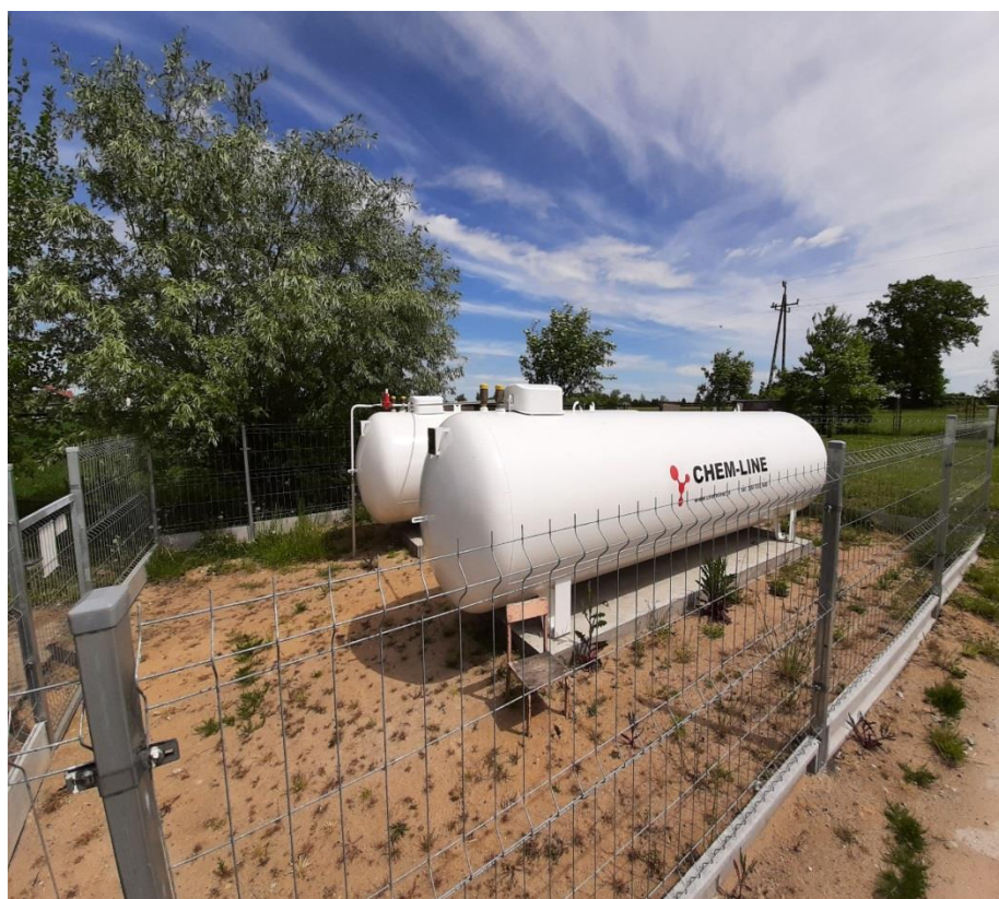
Naziemne zbiorniki gazu zasilające kotłownię w Szkole Podstawowej
