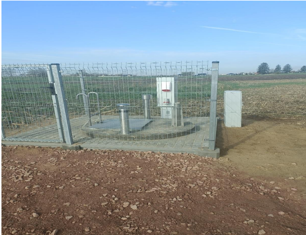
Przepompownia ścieków w Rogozinie ul. Makowa
