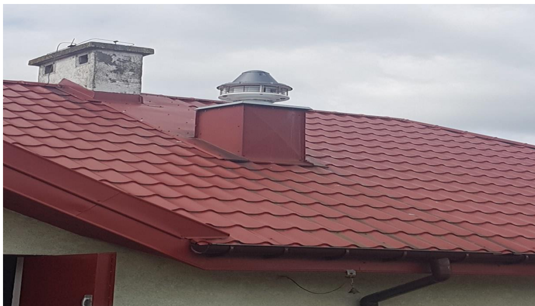
Wentylator dachowy na budynku oczyszczalni ścieków w Woźnikach.
