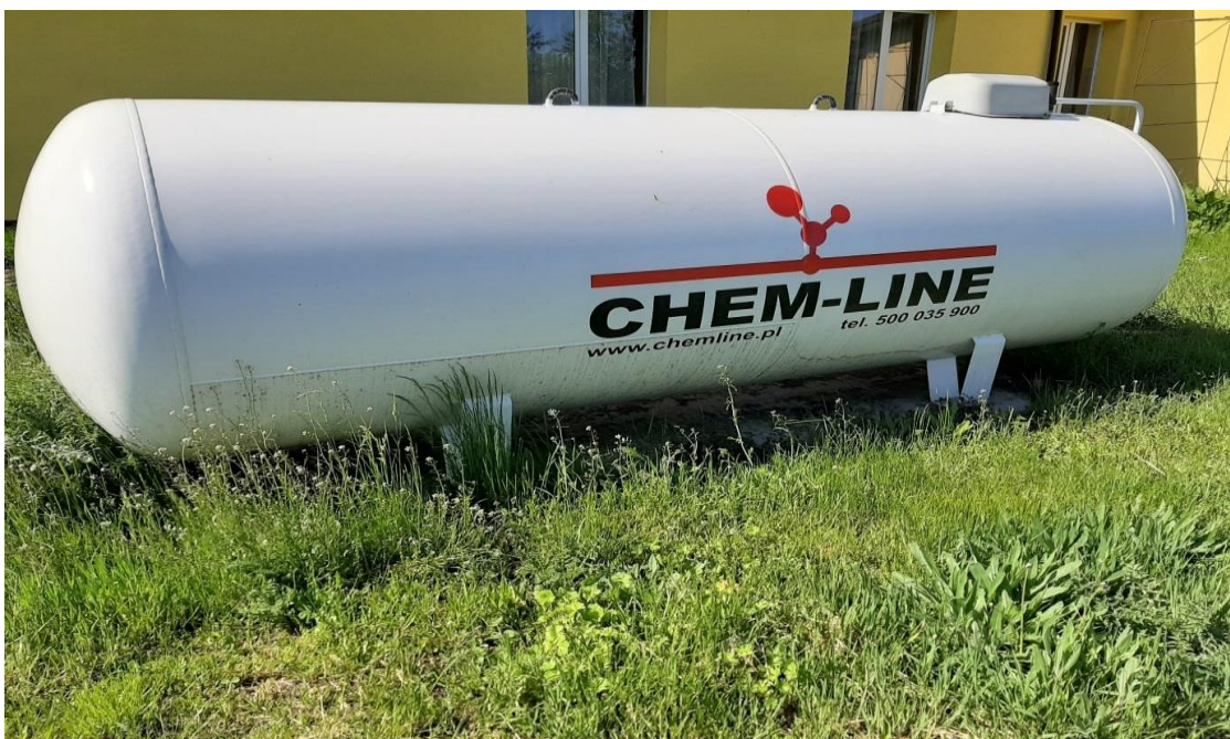
Butla na gaz zasilająca budynek OSP w Woźnikach.
