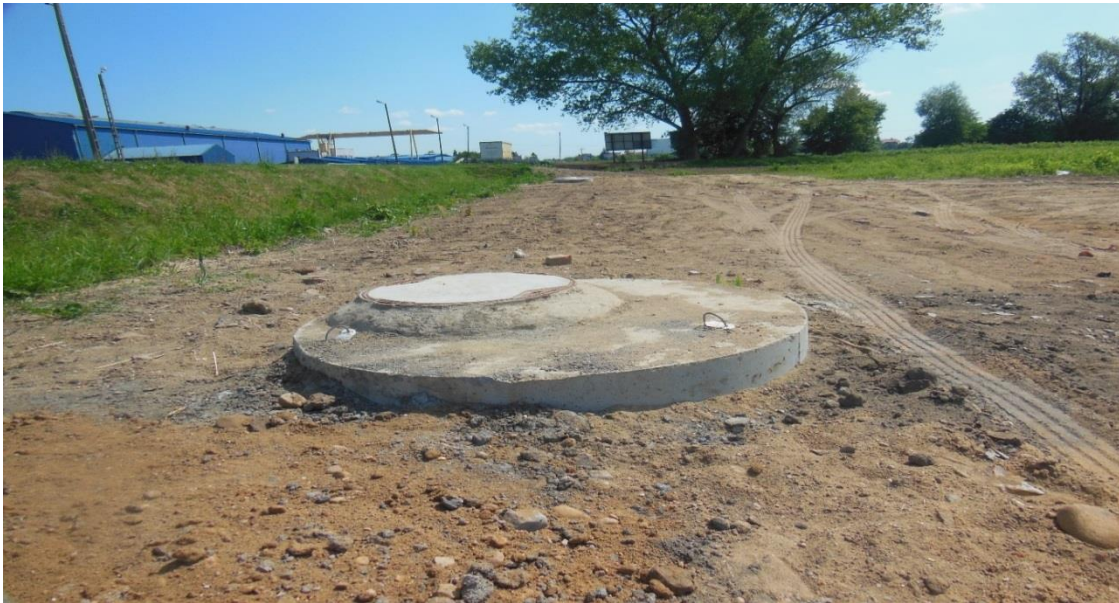
Studnia kanalizacyjna wzdłuż drogi wojewódzkiej nr 567, wybudowana w ramach rozbudowy sieci kanalizacyjnej.
