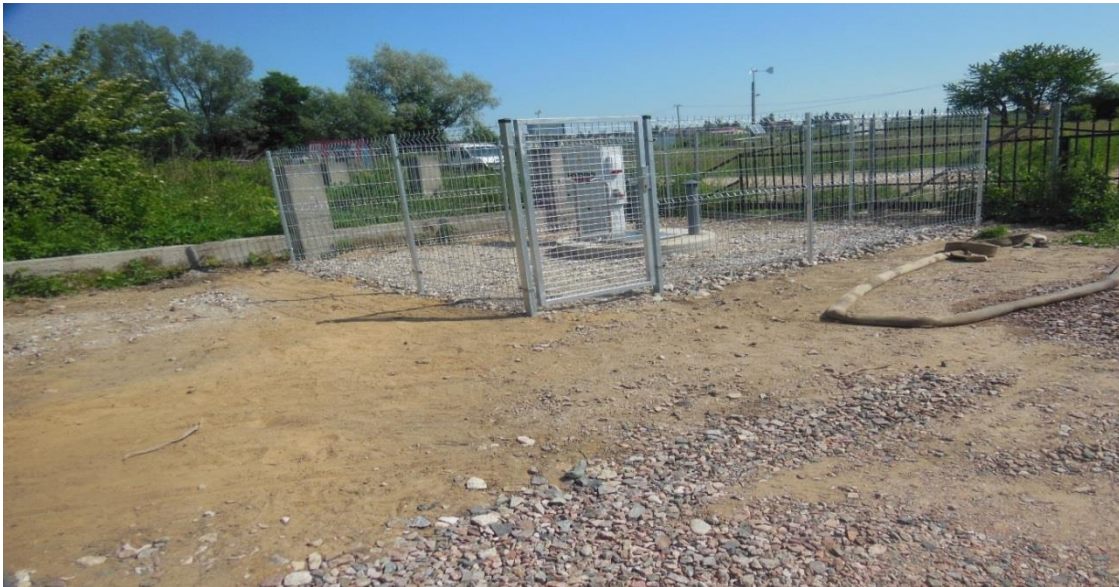
Jedna z przepompowni ścieków wybudowana w ramach zadania rozbudowy kanalizacji.
