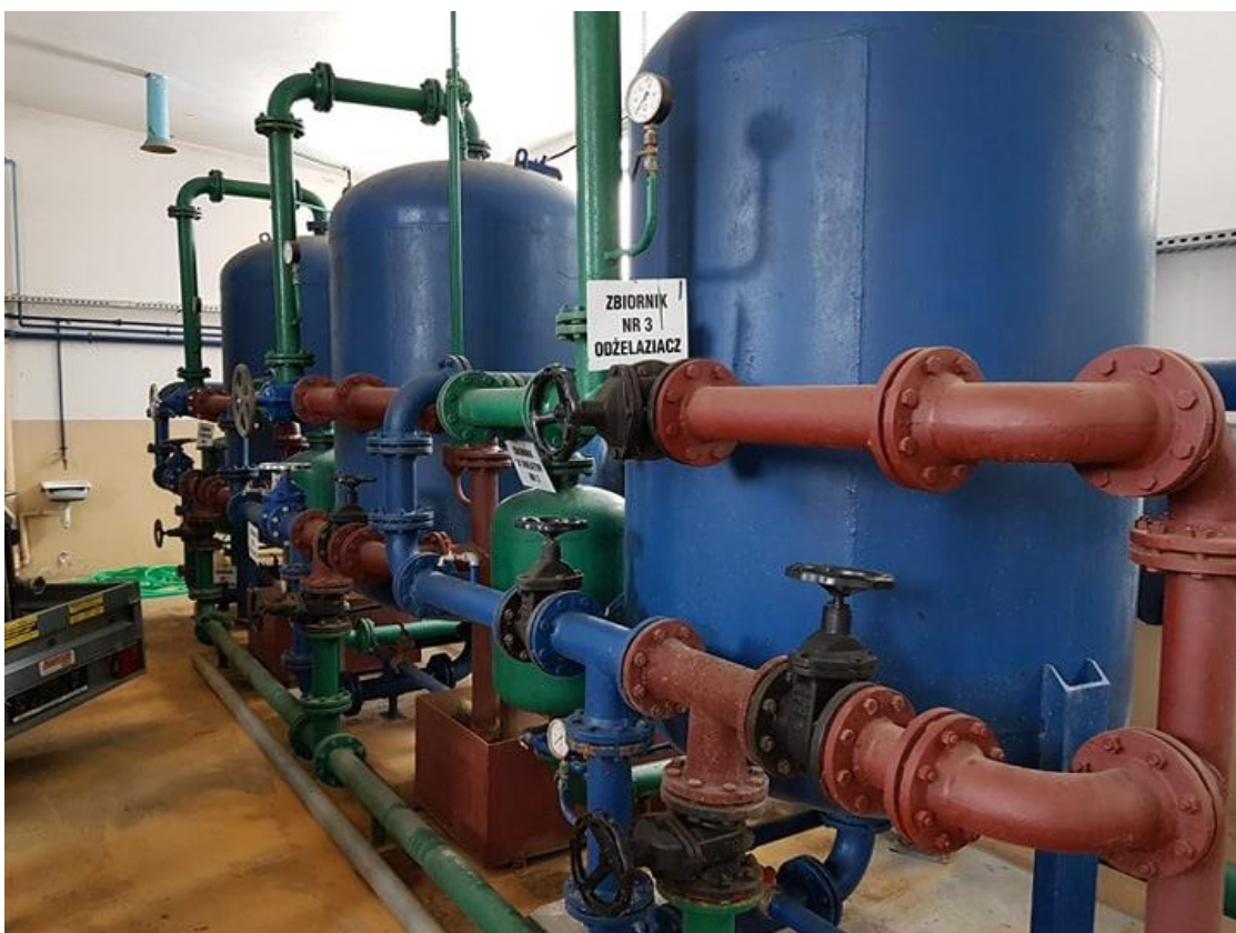
Część ciągu technologicznego wewnątrz Stacji Uzdatniania Wody w Radzanowie – Dębniakach.
