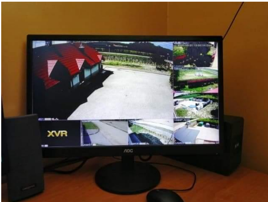
Rejestrator monitoringu oczyszczalni ścieków.
